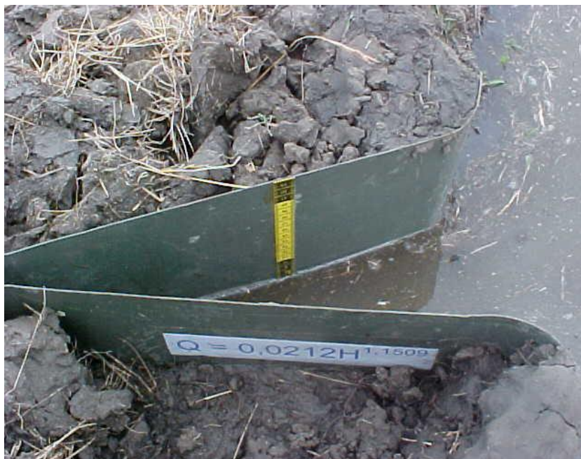
Figura 3. Calha Parshall instalada na entrada de um tabuleiro.
