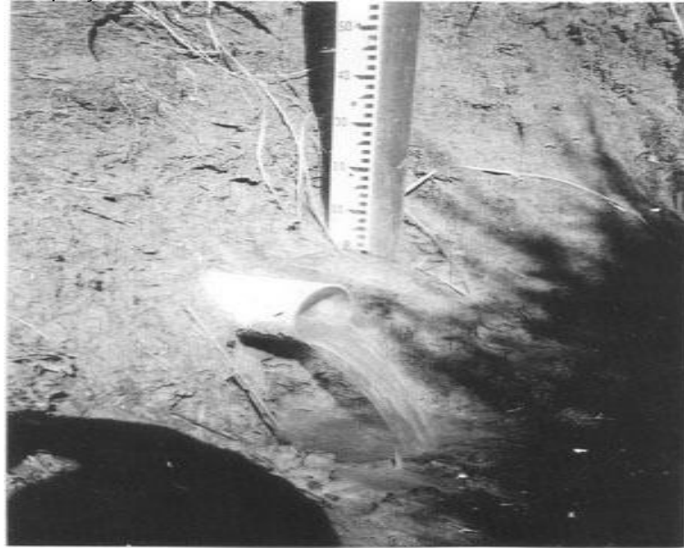
Dreno lateral subterrâneo com descarga para um canal coletor.
