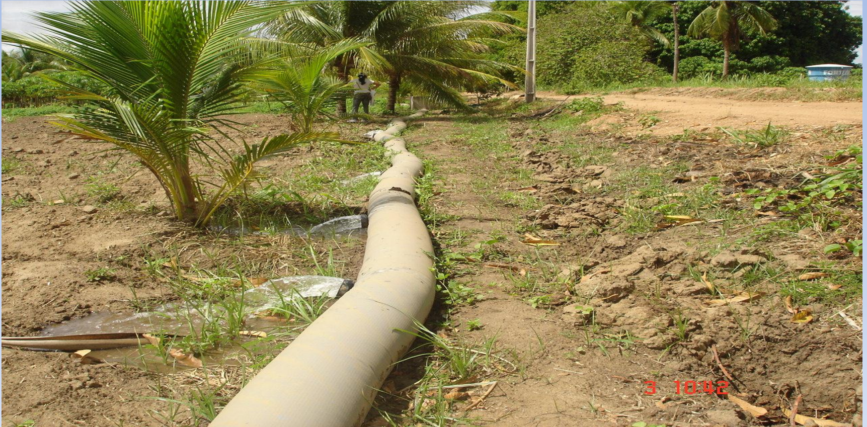
Figura 3. Politubo janelado para condução e aplicação de água.
